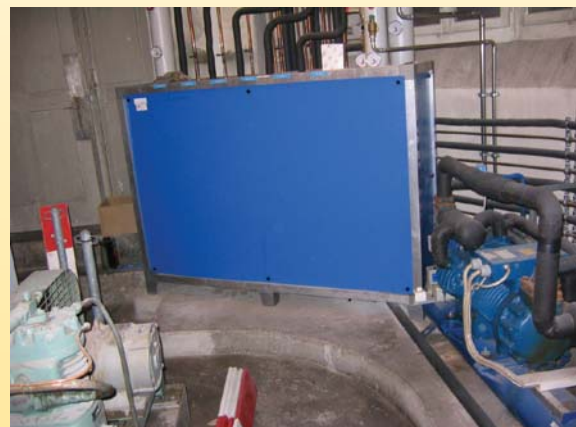
Kompaktstation der Abwärmenutzung
